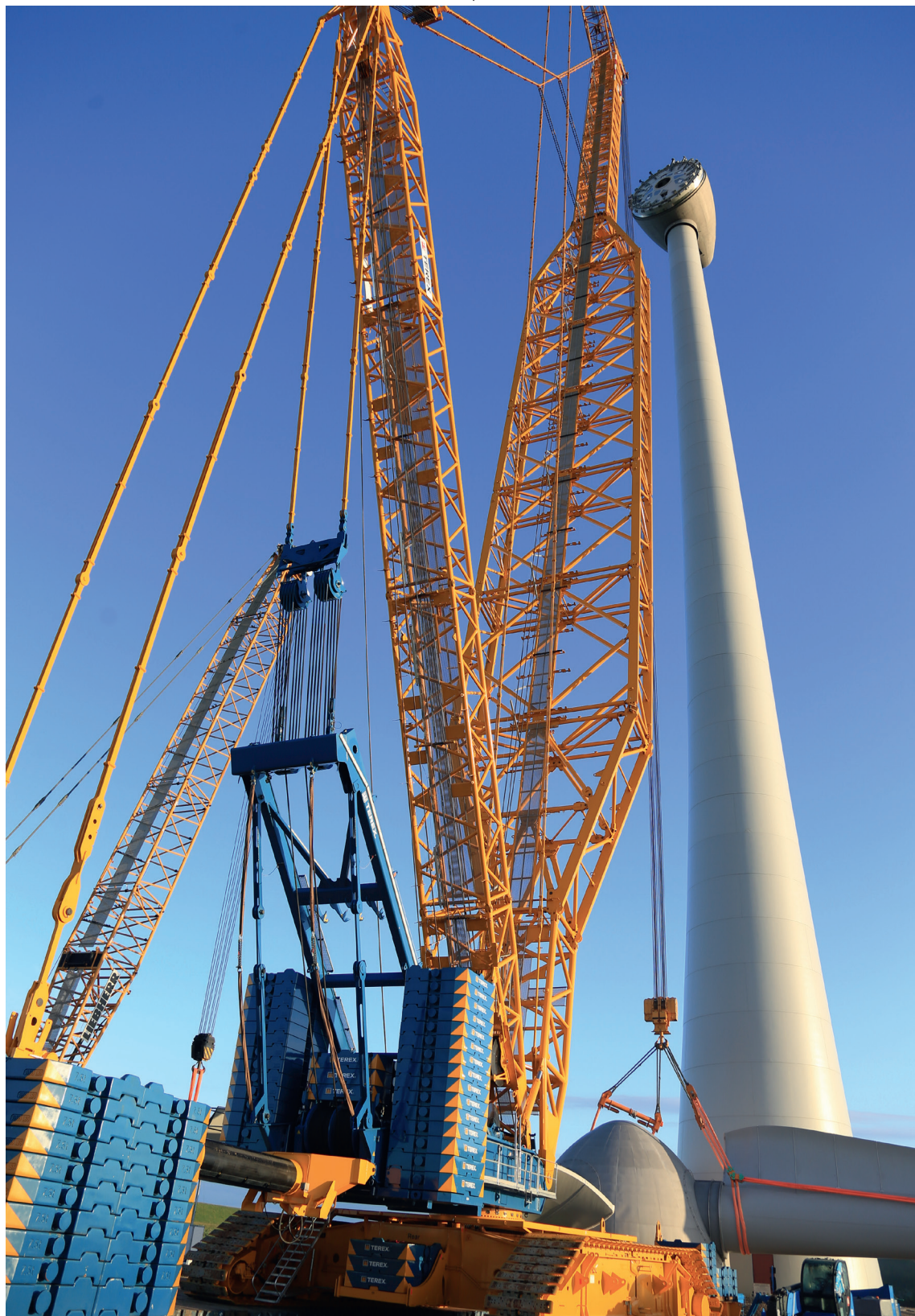
FOTO 3.13 DE EERSTE KRAAN UITGERUST MET EEN LOKAAL VERBREDE GIEK, DE DEMAG CC8800-1 MET DE BOOM BOOSTER
